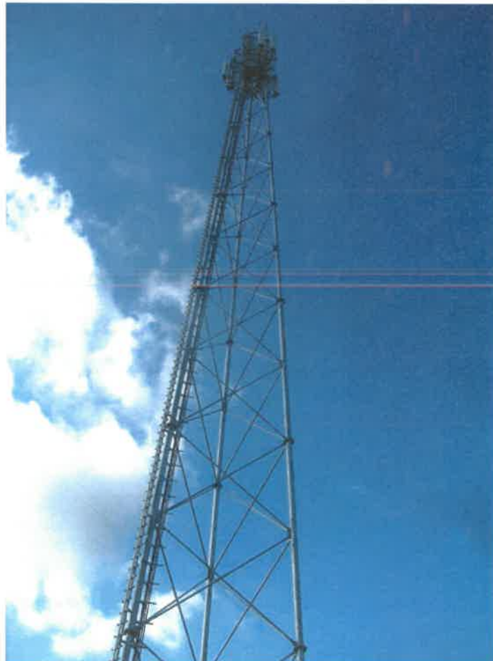
Zał. nr 1: Widok ogólny instalacji radiokomunikacyjnej.
