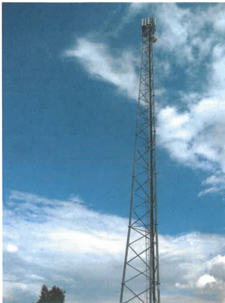
Zał. nr 1: Widok ogólny instalacji radiokomunikacyjnej.
