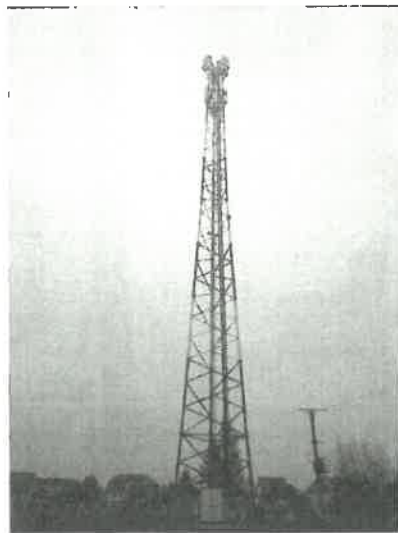
Widok obiektu wraz z zainstalowanym zespołem antenowym
