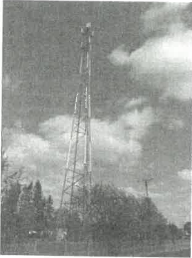
Widok obiektu wraz z zainstalowanym zespołem antenowym
